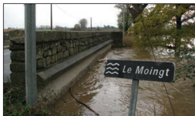
Crue du Moingt, 2008. Source : Ville de Montbrison.
